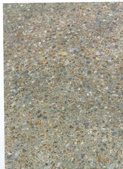
Béton érodé à granulats clairs / VARIANTE
