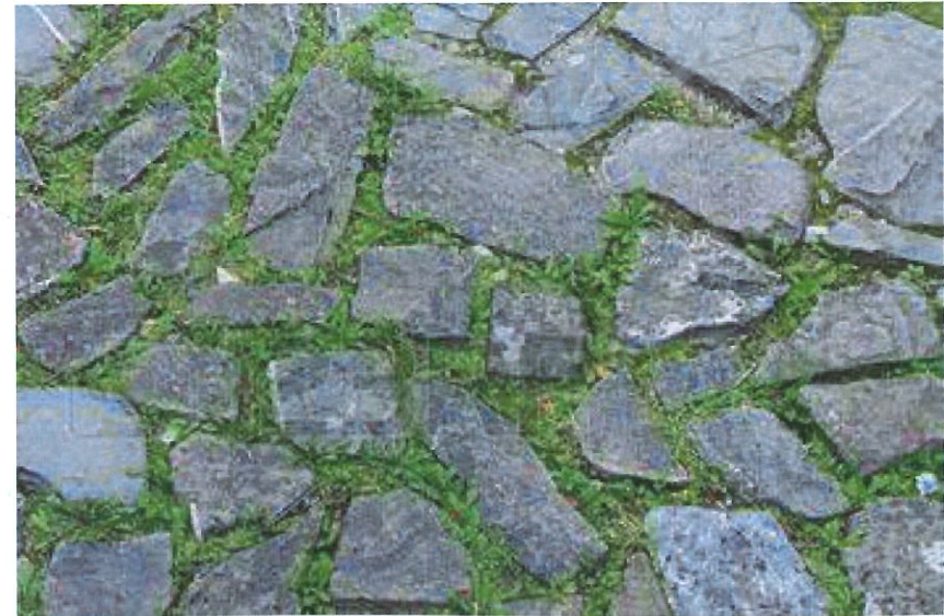
Accès camping sud : principe de dallage en granit et joints végétalisés en opus incertum
